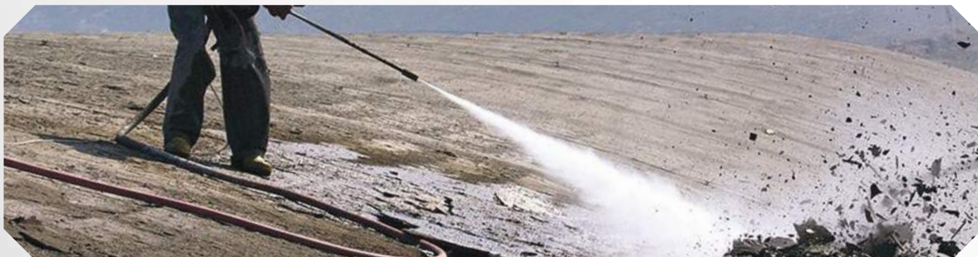
Мойка заводских дорожных покрытий
