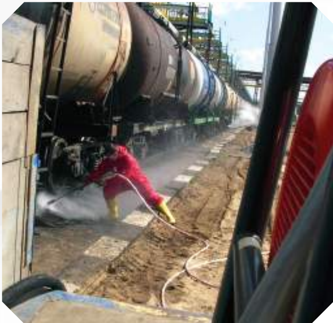
Мойка поверхностей от нефтехимических загрязнений
